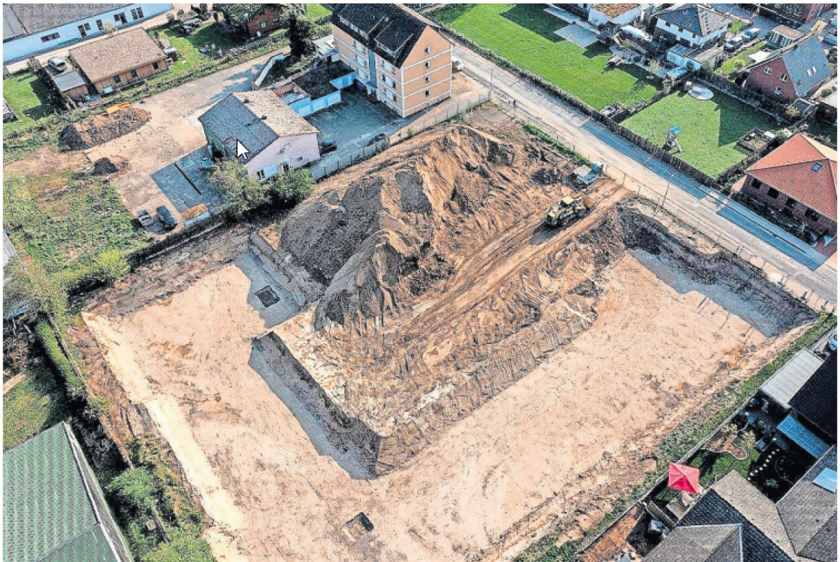
Der Baugrube in der Glückaufstraße folgen in den nächsten Tagen die Bodenplatte und das Kellergeschoss.
